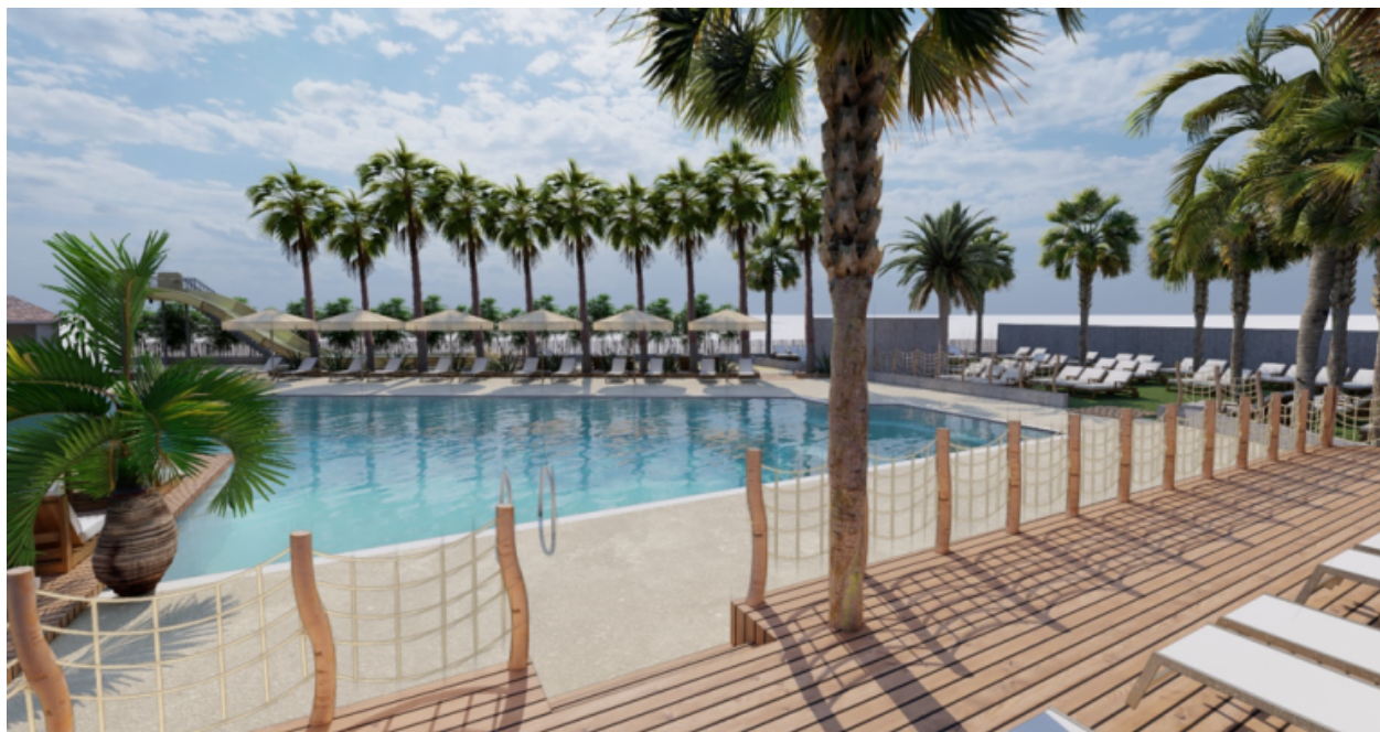
Le parc aquatique du camping-village La Marende, à Argelès-sur-Mer (66), est en cours de renouvellement. ©Yelloh ! Village
